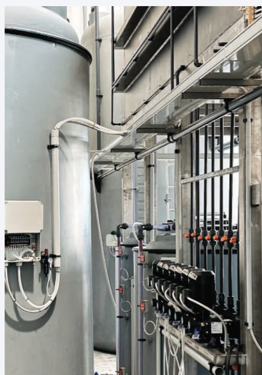
A sinistra: impianto di depurazione In basso: banco di certificazione prodotti Left: purification plant Below: product certification bench
